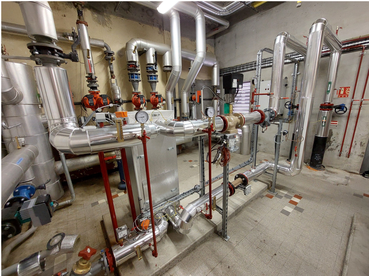
Sous-station du réseau de chaleur installée à l'Icam - ©Coriance
