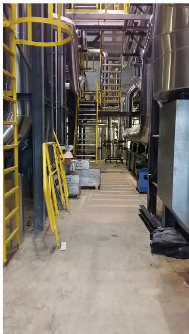
Vue intérieure de la chaufferie ©MRN
